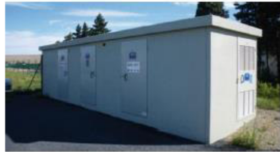
Photographie 8 : Poste de livraison (Source : ENCIS Environnement)
