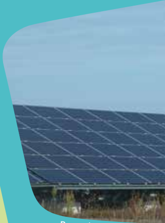
Parc solaire TIPER 3 et éolienne TIPER
