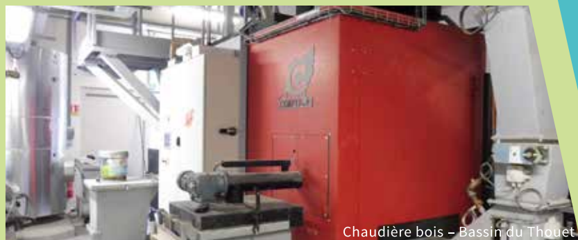
Chaudière bois – Bassin du Thouet
