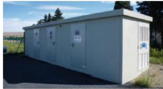
Photographie 8 : Poste de livraison (Source : ENCIS Environnement)
