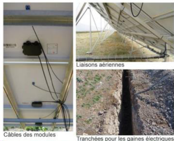
Photographie 9 : Liaisons électriques (Source : ENCIS Environnement)
