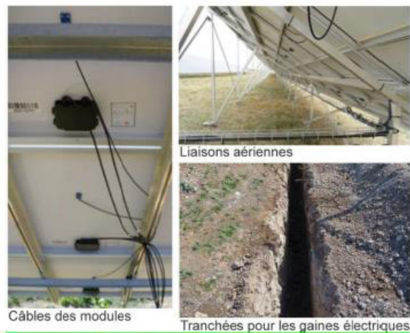
Photographie 9 : Liaisons électriques (Source : ENCIS Environnement)
