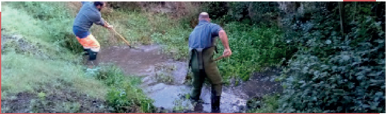
↳ Intervention en cours de la cellule « espaces verts » sur la mare permanente (site n°1) et état de cette mare après travaux
