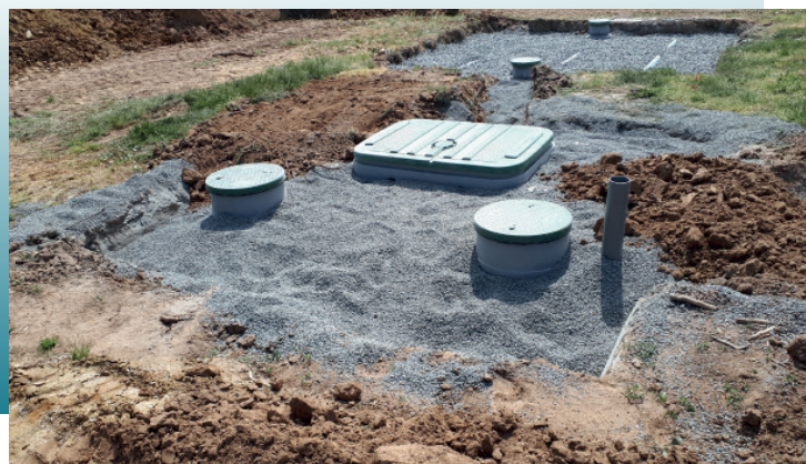
↳ Filtre compact 5 E.H suivi d'un lit de dispersion de 16 m 2 Exemple d'installation photographiée lors d'un contrôle avant remblaiement
