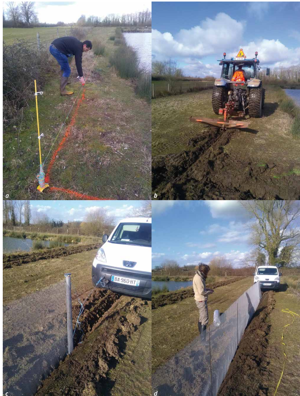
Figures 113a, 113b, 113c, 113d. Préparation de la tranchée et pose du grillage. Photos ©CCT
